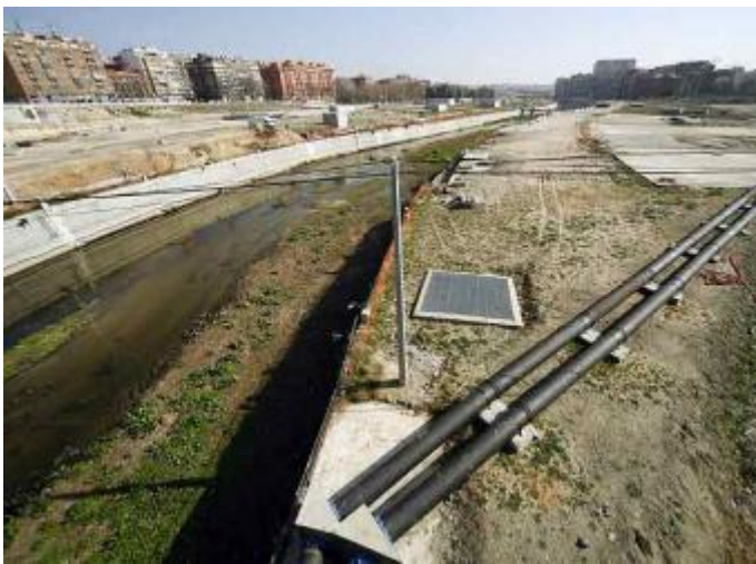
Perspectiva de la Avenida del Manzanares entre los puentes de Toledo y de Praga- PAULA VILLAR
