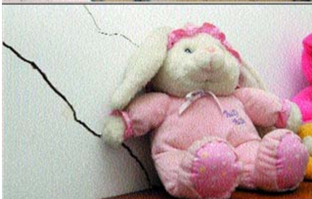
Los vecinos miran con preocupación las grietas de sus viviendas en el edificio situado en el número 53 del paseo Imperial, situado en el distrito de Arganzuela. (Foto: Miguel G. Rodríguez)
