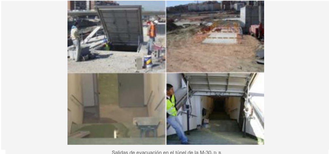
Salidas de evacuación en el túnel de la M-30- D. B.
