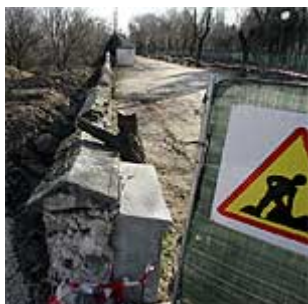
Tapia de la Casa de Campo demolida parcialmente por las obras de la M-30. (GORKA LEJARCEGI)
