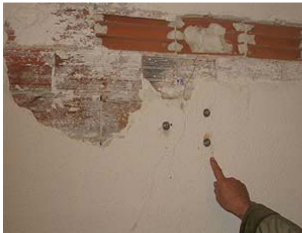
Un vecino enseña una grieta en un piso del inmueble. (elmundo.es)
