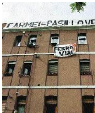
El Ayuntamiento y Renfe deberán ponerse de acuerdo con Ferrovial para reparar los daños causados al edificio de paseo Imperial, 53.
